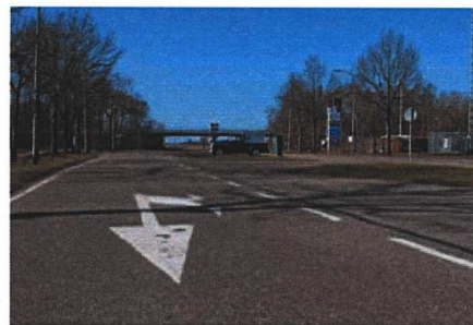
Brede, uitlubberende asfaltverharding
