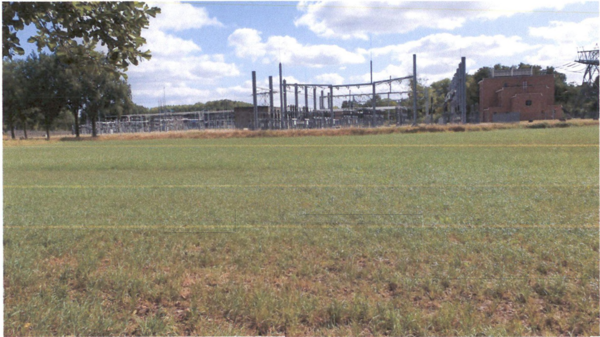
Figuur 1: Zicht op trafo station vanuit pand [REDACTED]
